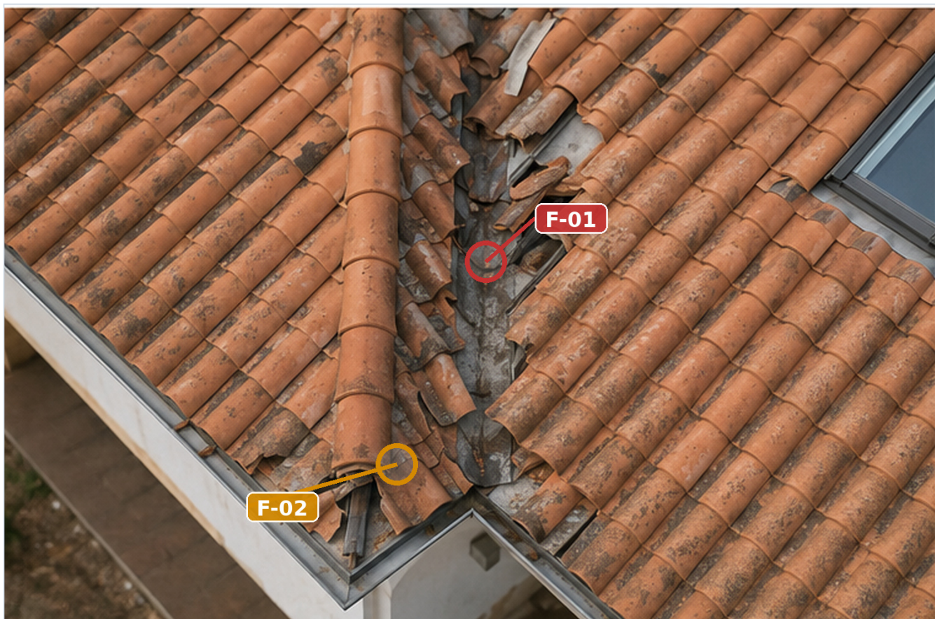
Figura 2. Detalle oblicuo de la cubierta. Las marcas se añaden sobre una copia de trabajo; el archivo original se conserva sin anotaciones. Imagen generada para este caso simulado.
