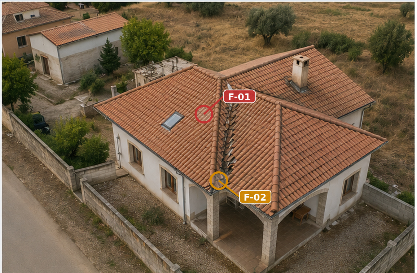
Figura 1. Vista oblicua general. F-01 identifica la discontinuidad principal en el encuentro de faldones; F-02 localiza el remate de alero que requiere comprobación. Imagen generada para este caso simulado.
